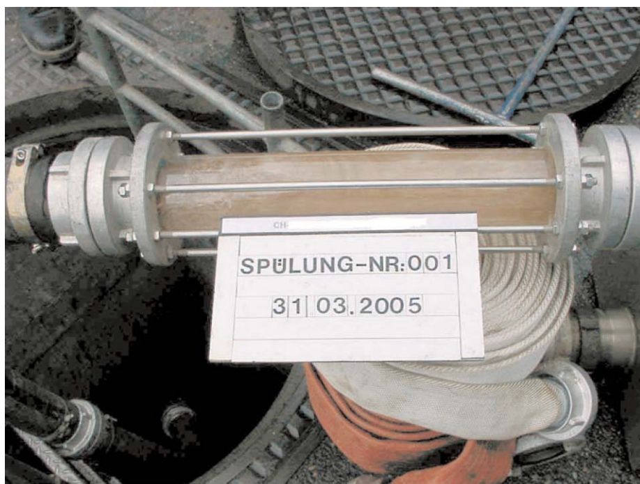
Abb. 2 Sichtfenster zur Überwachung und Dokumentation des Spülvorgangs.
