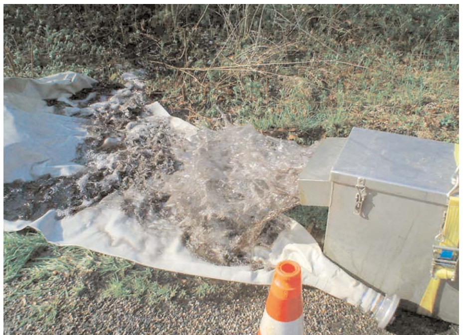
Abb. 1 Schmutzwasser, welches während der ersten Spülstösse aus der Wasserleitung austritt.
